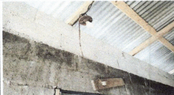
Foto 10: Cableado eléctrico dañado
