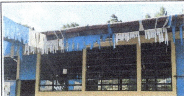
Foto 7: Canales de agua en estado deficiente y reposición de vidrios faltantes
