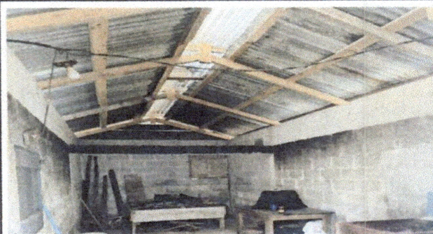
Foto 2: Estructura y techo de cocina en mal estado y estufa rural que necesita sustitución
