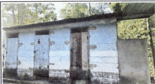
Foto 3: Estructura, techo, puertas y pintura de baños en mal estado
