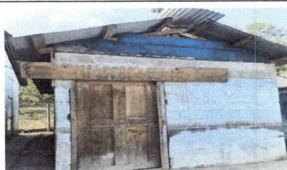
Foto 4: Puerta de cocina que necesita ser sustituida, y paredes que necesitan ser remozadas
