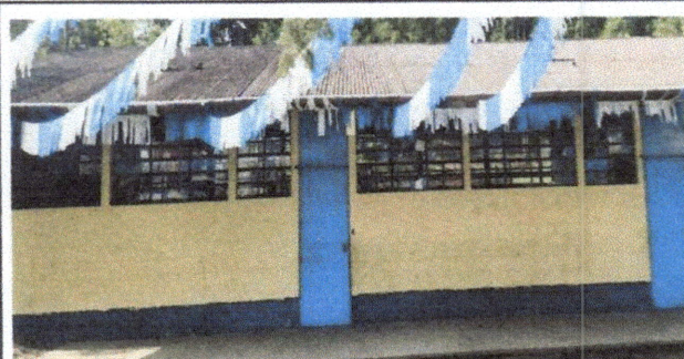
Foto 8: Pintura exterior deteriorada
