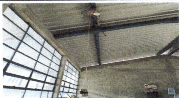
Foto 9: Cableado eléctrico dañado
